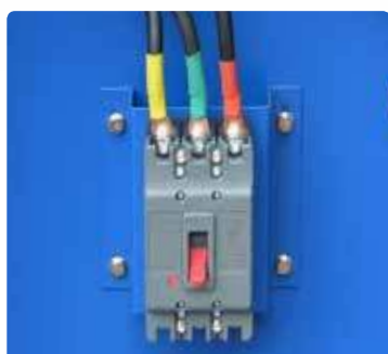
Автомат защиты генератора
